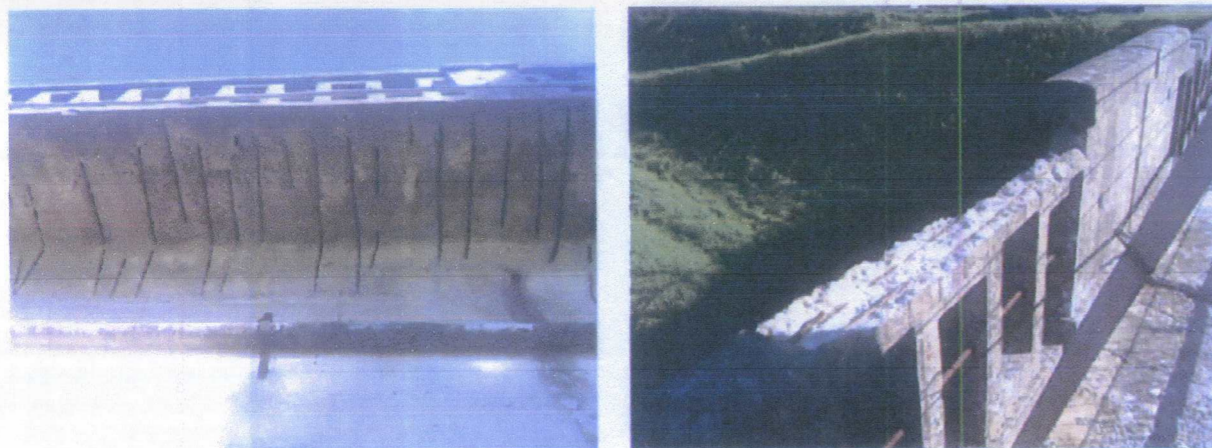
Foto n.1, 2 – degrado in atto della struttura in cemento armato
